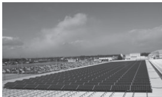
太陽光発電システム
